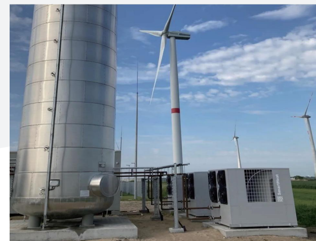
德国Bosbüll市区域集中供热 类型：aero 168 用途：区域集中供热
