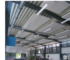
金属吊顶板 Metal ceiling panels
